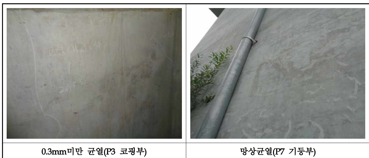
【사진 3.2.11】 교각 손상현황(대구)
