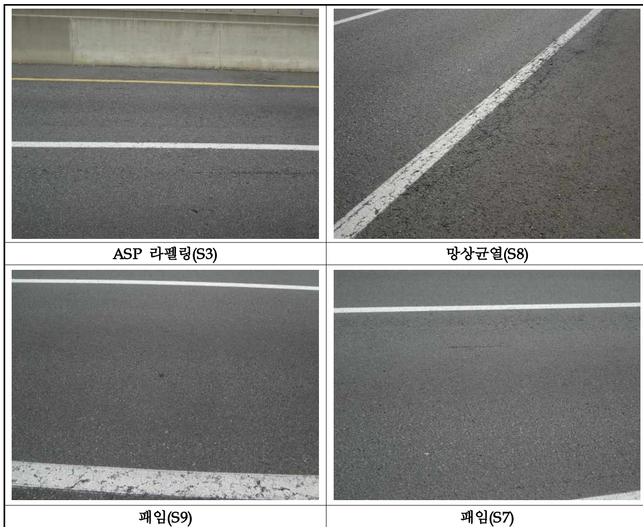
【사진 3.3.18】 교면포장 손상현황(부산)
