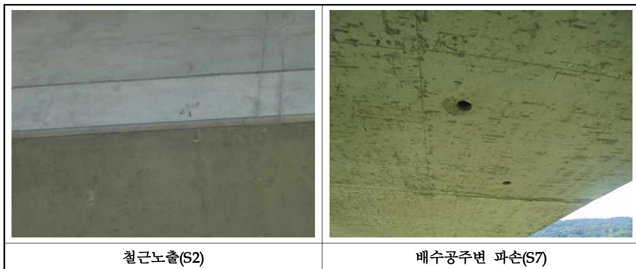
【사진 3.3.2】 거더외부 손상현황(부산, 계속)
