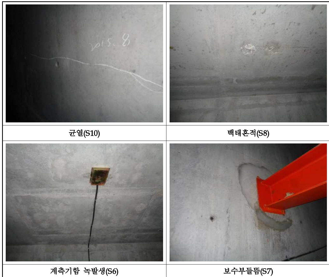
【사진 3.3.4】 거더 내부 손상현황(부산,계속)
