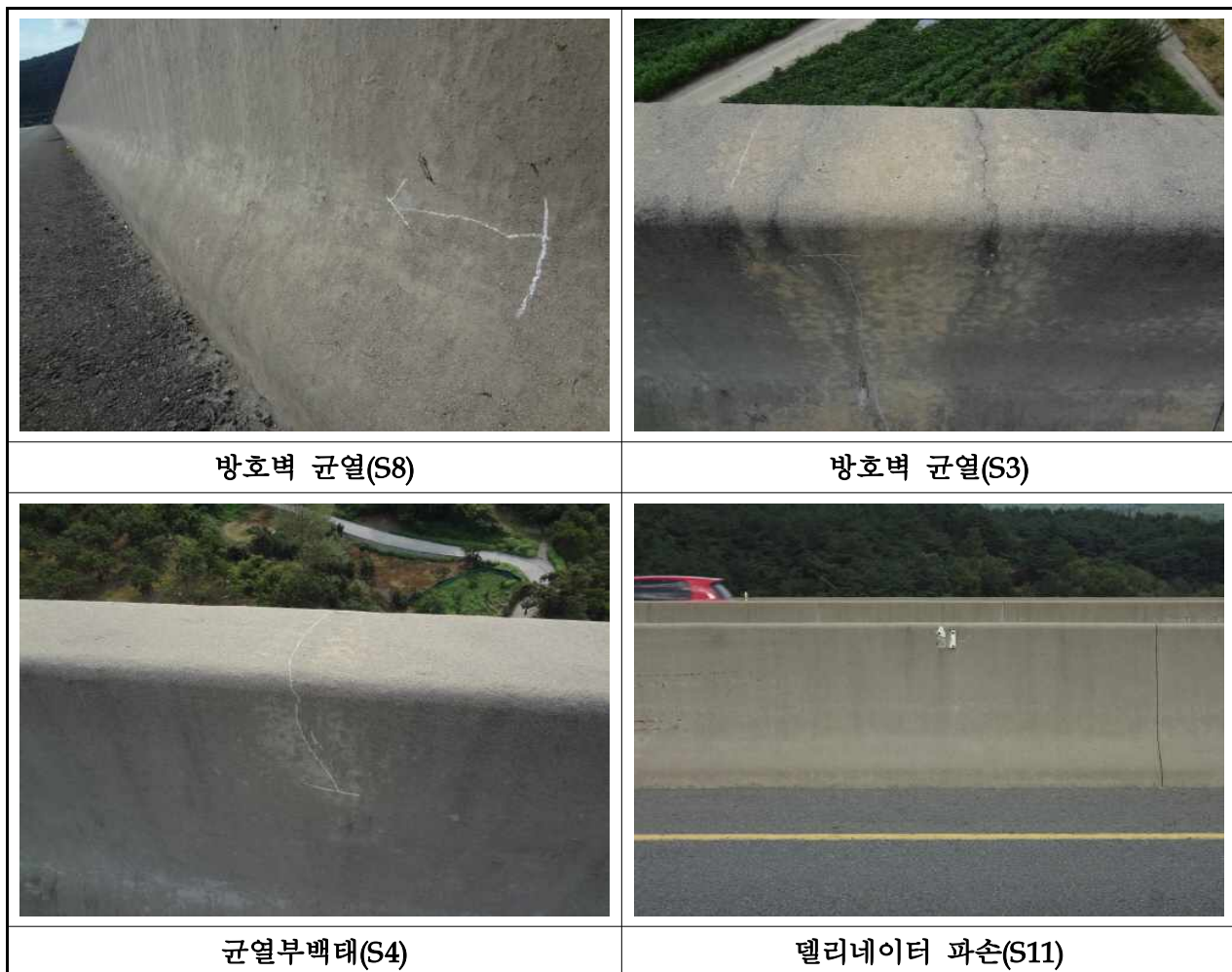
【사진 3.3.22】 난간 및 연석 손상현황(부산)
