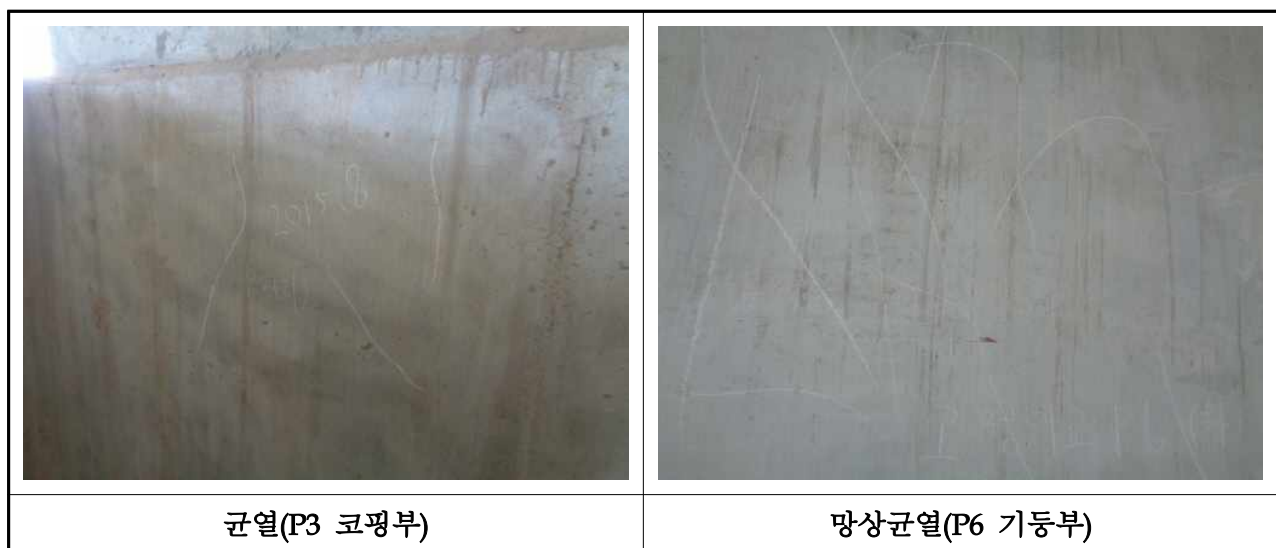
【사진 3.3.10】 교각 손상현황(부산)
