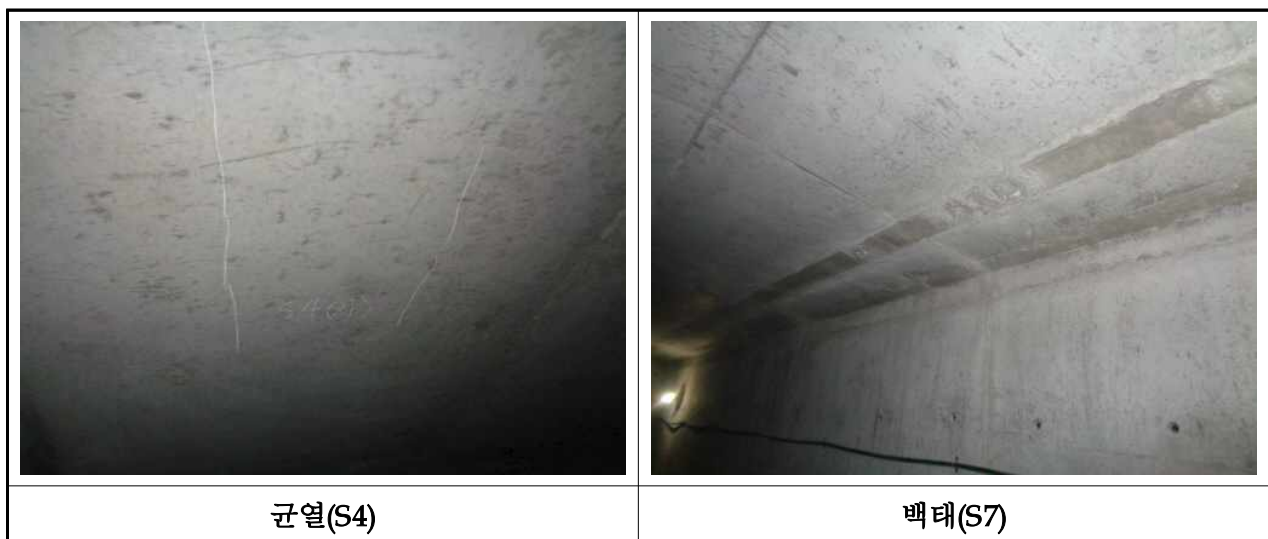
【사진 3.3.4】 거더 내부 손상현황(부산)
